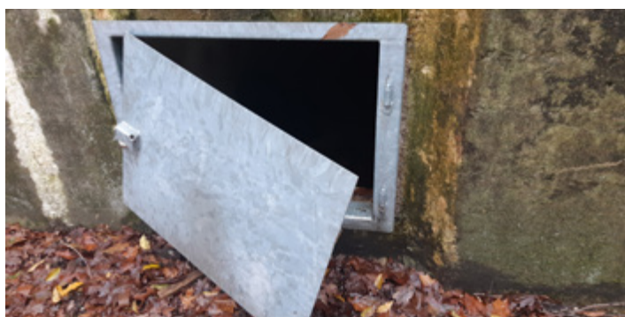
opgebroken toegangsdeur tot winterverblijf.
